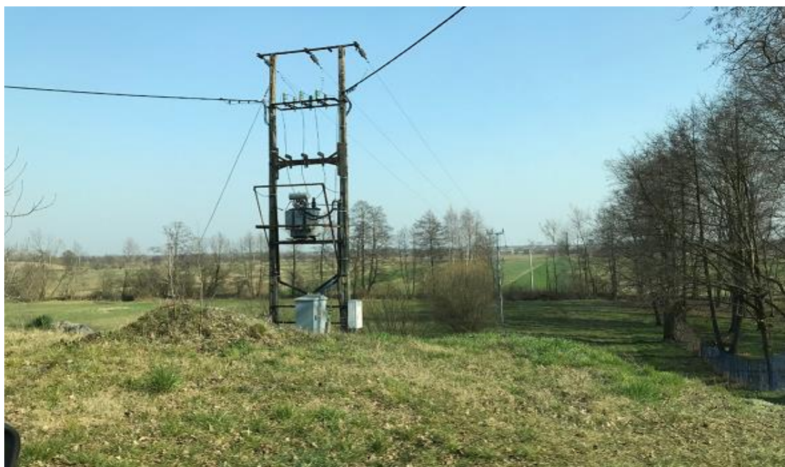
Fot. 4. Stacja transformatorowa w miejscowości Biernacice oraz skarpa w tle
